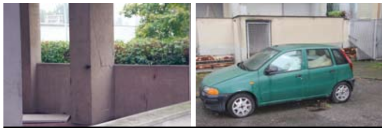
In alto a sinistra, Nardiello mostra il citofono roto. Poi il carraio sempre aperto, il pilastro crepato e una delle auto piena di rifiuti abbandonate nel cortile interno
